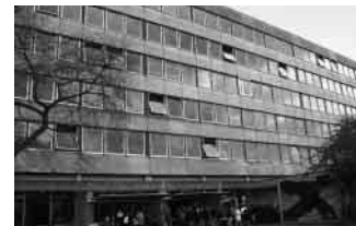
Die quadratischen, in der Mitte gelagerten Schwingflügel der Fensterbänder in der Ost- und Westfassade entsprachen nicht mehr den Anforderungen der aktuellen Wärmedämmstandards und waren nach all den Jahren überdies reparaturanfällig geworden.
